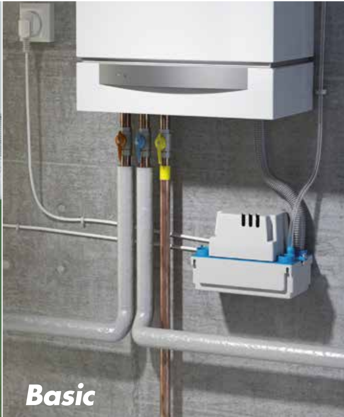
Bombas de condensados
